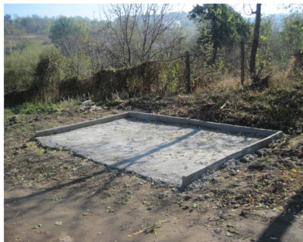
Platforme pentru colectarea DMS
