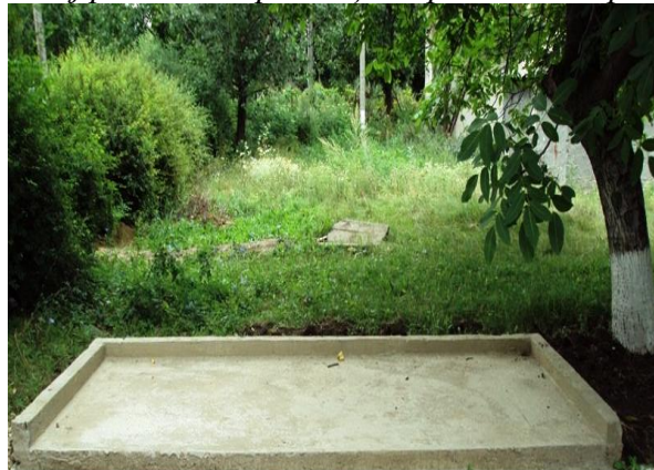
Platforme pentru colectarea DMS
